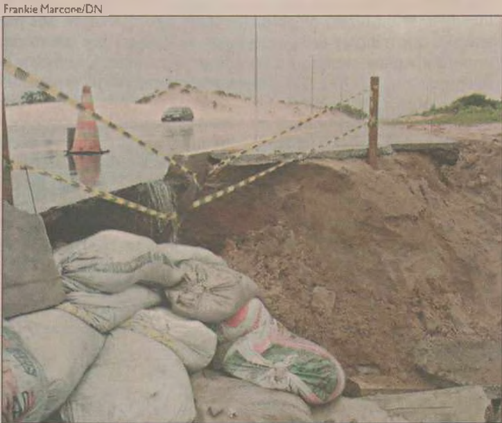
Calçadão que dá acesso à nova ponte, no lado da Redinha: desmanchado
