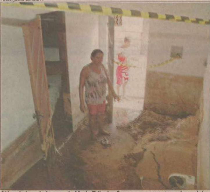
Além de inundada, casa de Maria Edinalva ficou em parte soterrada: prejuízo
