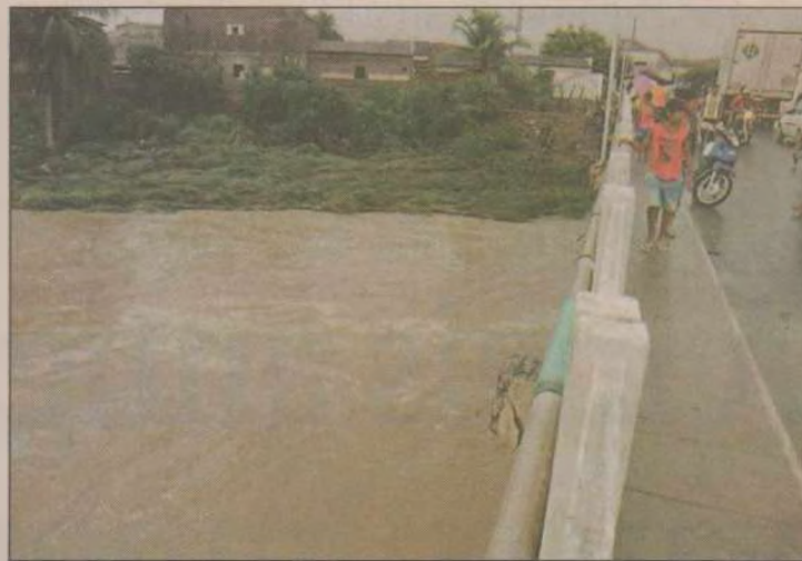
Rio que corta cidade de Santa Cruz: correnteza destruiu base da ponte
