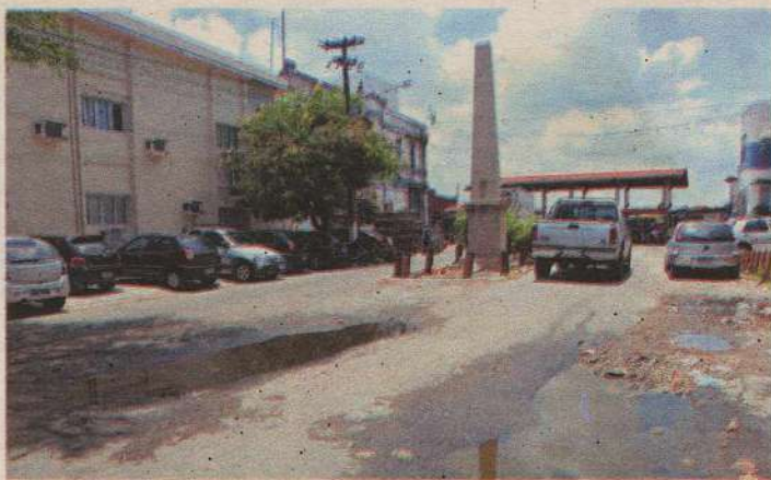
Esgoto a céu aberto toma conta do obeslço na Avenida Tavares de Lira
