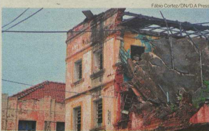
Prédio do Arpège já perdeu parte de sua estrutura e ameaça cair de vez
