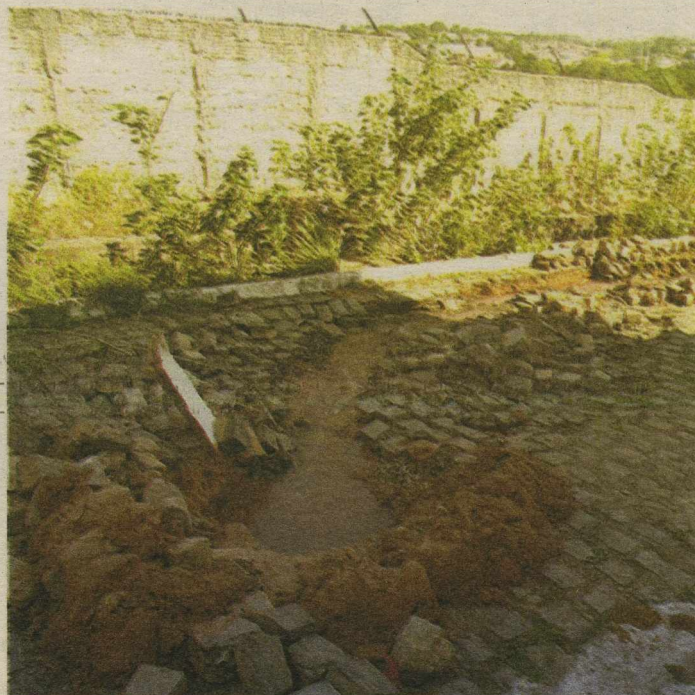
Buraco na Rua Mira Torres estava jorrando água ontem
