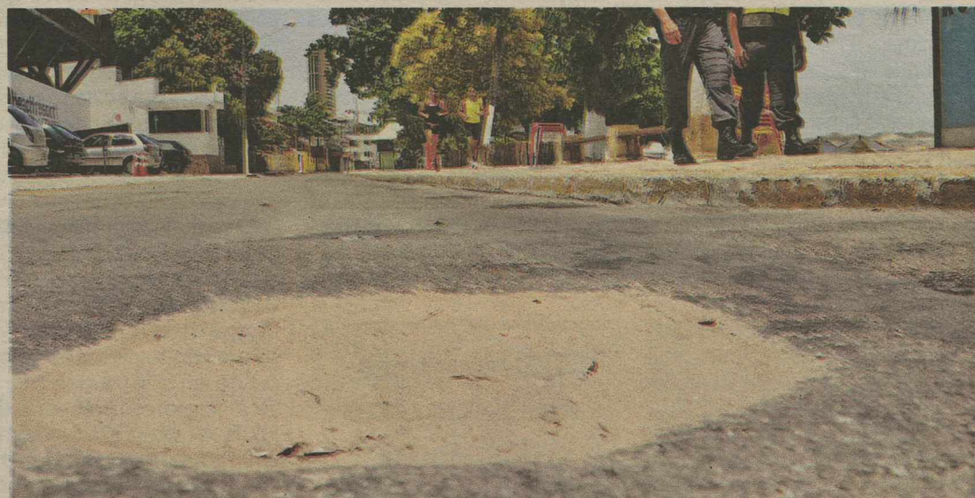
Semopi diz que problemas de fornecimento de asfalto estão atrasando operações tapa-buraco na Erivan França
