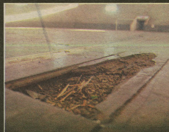
Acima bebedouro depredado e estrutura corroída pela ferrugem no ginásio do DED, abaixo o piso do Machadinho
