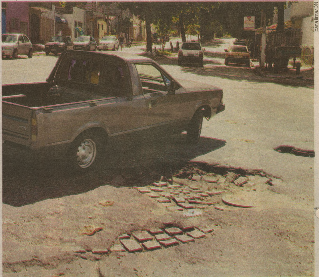
Extenso buraco é apenas um dos perigos que elevam risco de acidentes na rua do bairro de Dix-Sept Rosado
