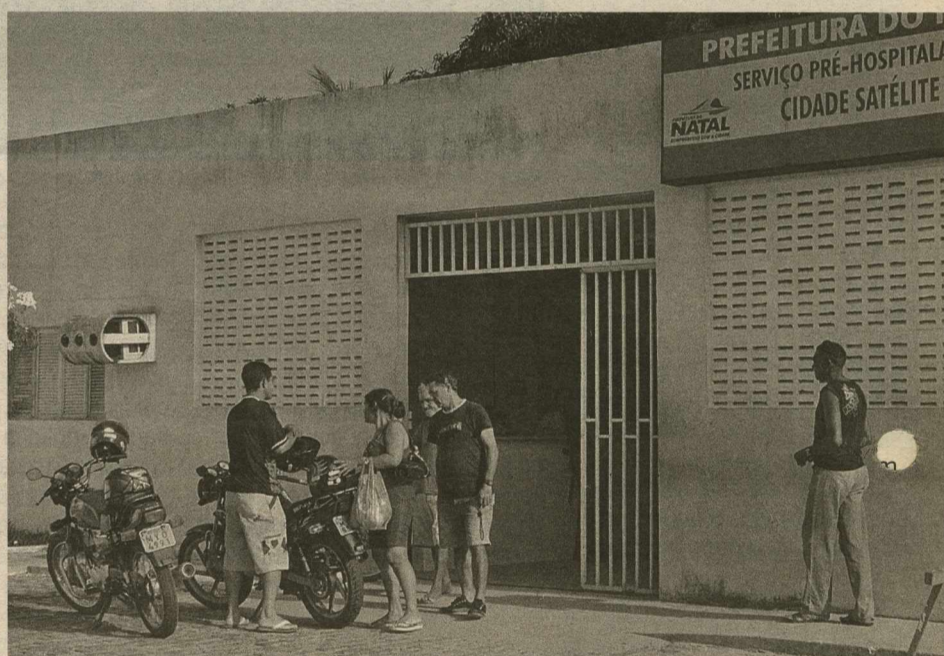
Zona Sul: infiltração de água no telhado é apenas uma das dificuldades em Cidade Satélite
