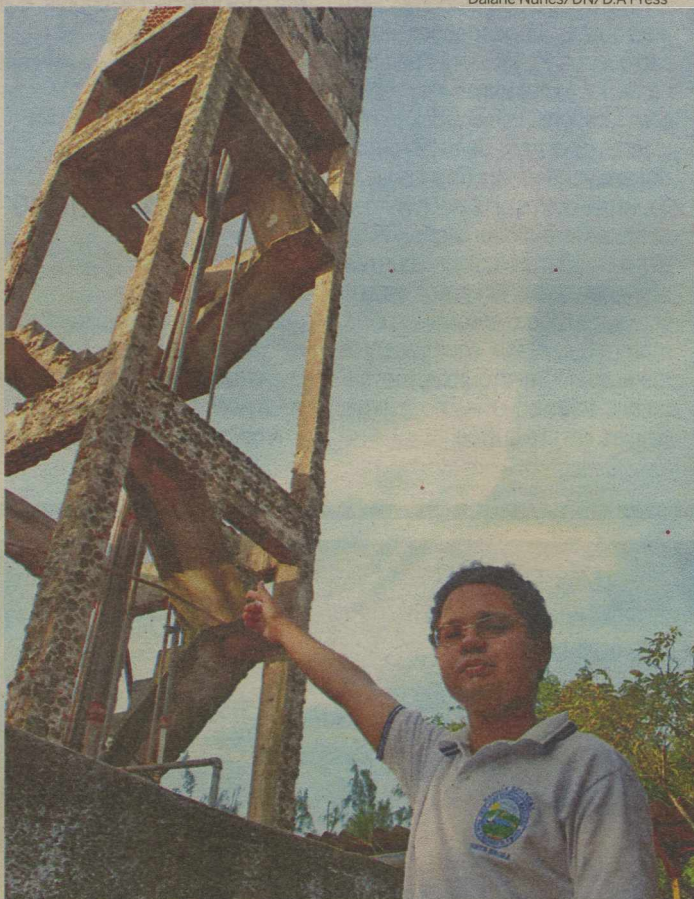
José Rafael, 18 anos, mostra a caixa d'água que ainda tem vazamento
