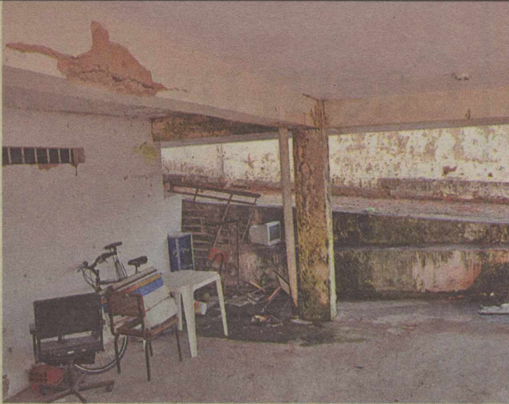
Falta de manutenção e limpeza prejudica PMs, agentes e detentos
