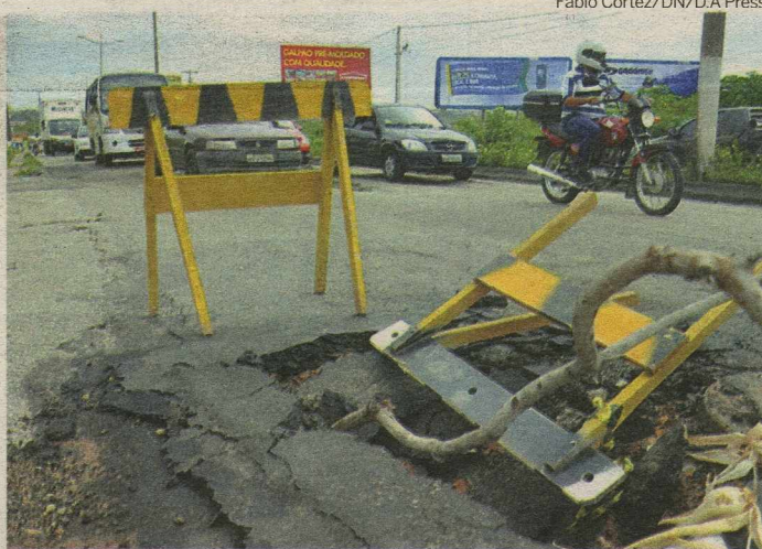
Problemas viários vêm sendo registrados há tempos na avenida
