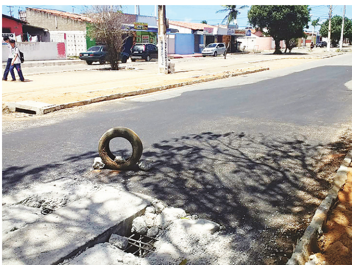
// Buraco já causou diversos acidentes de trânsito na avenida
