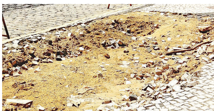
//Em Ponta Negra, pedras se desprendem por falta de manutenção
