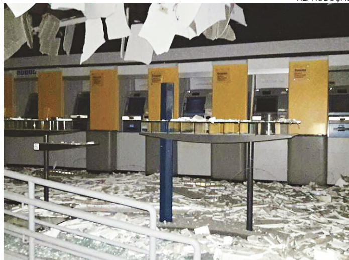
// Explosão destruiu a agência do Banco do Brasil de Monte Alegre
