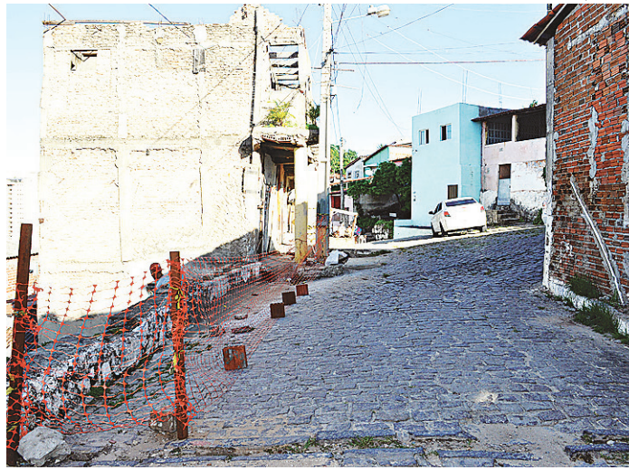
// Área afetada em Mãe Luíza: oito imóveis correm risco de desabar
