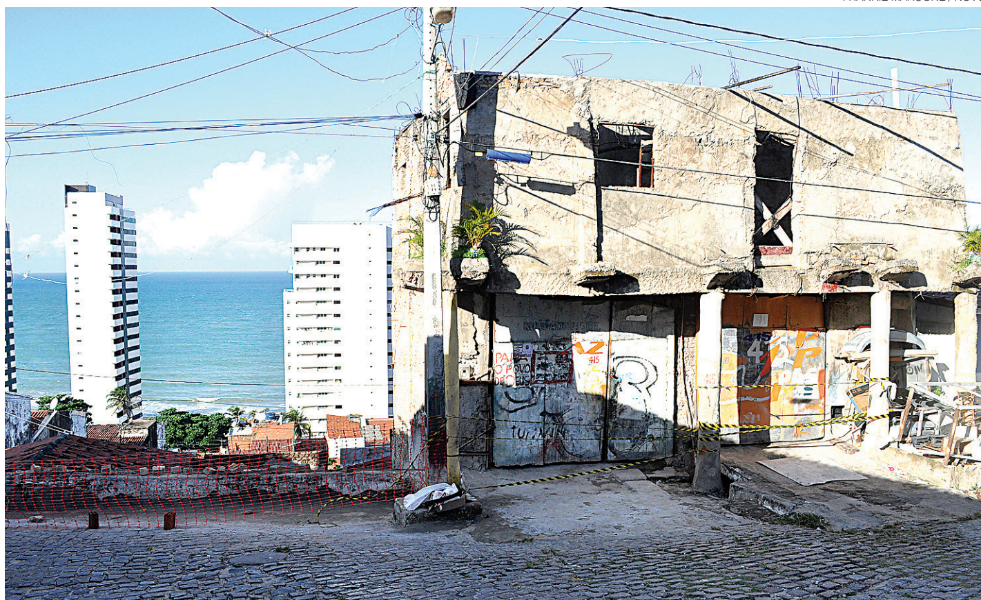
// Solução apontada pela Prefeitura é reforçar muro de contenção e demolir o primeiro andar do imóvel onde hoje funciona uma oficina
