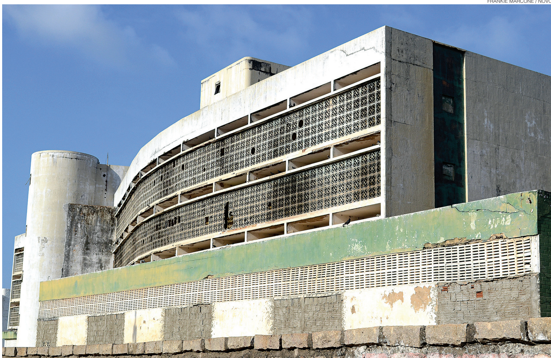
// À beira-mar e em área nobre da cidade, prédio que está fechado desde 1995 sem as mínimas condições de uso, poderá agora ser demolido para dar lugar a novo empreendimento
