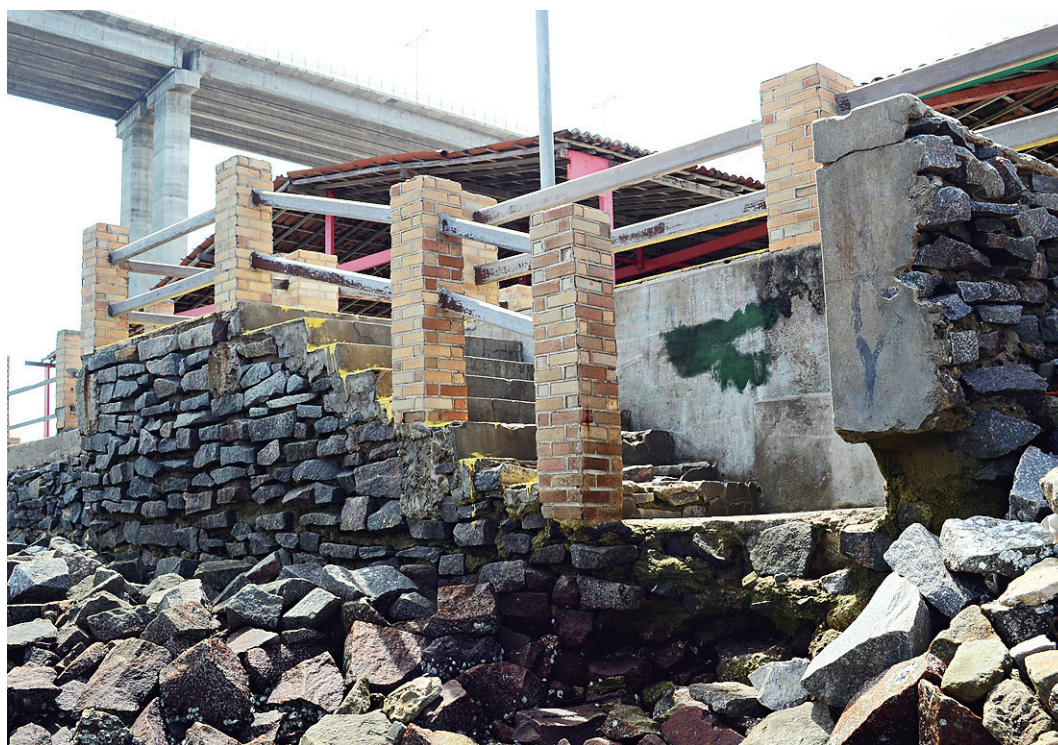
// Em péssimas condições, usar essa escadaria na praia da Redinha é um risco para qualquer pessoa
