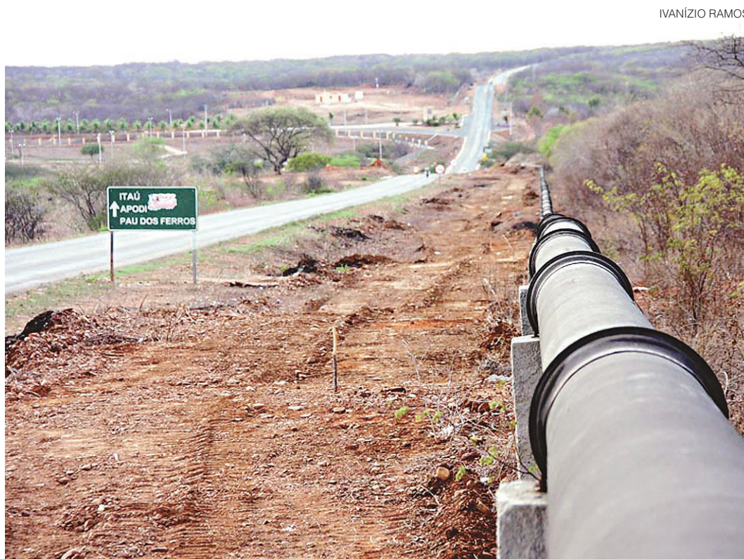
// Adutora do Alto Oeste vai beneficiar 208 mil pessoas de 26 municípios da região
