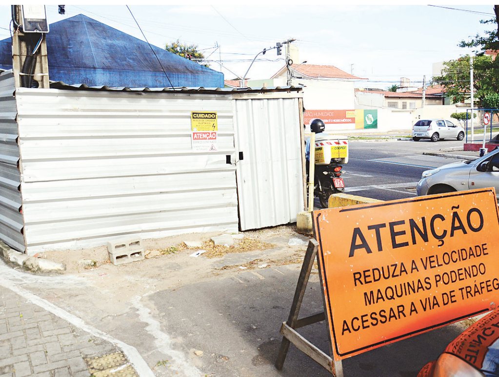
// Construção de poço na obra de drenagem da avenida Capitão Mor Gouveia
