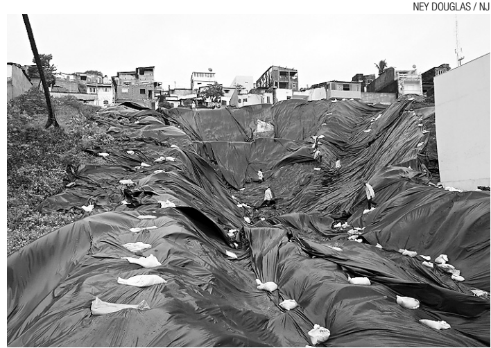
▶ Contenção da área foi providenciada e permanece sob supervisão
