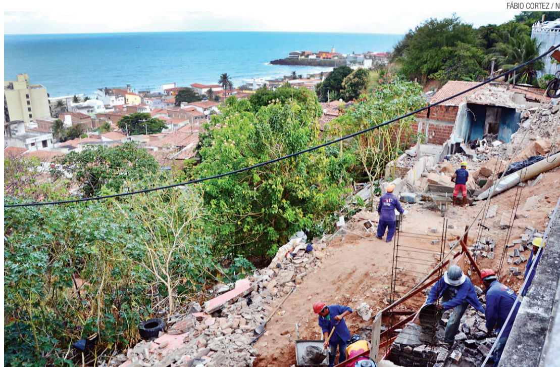
Operários executam serviços de contenção contra desmoronamentos de resíduos no local projetado para o mirante
