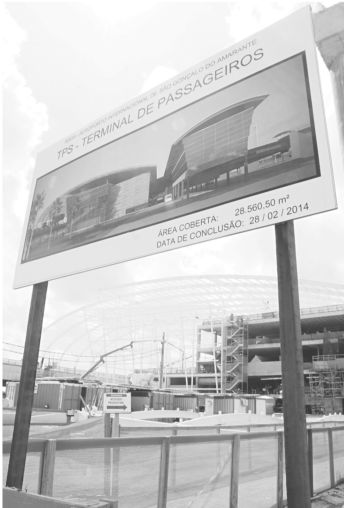
► Instalação da estrutura metálica do teto está adiantada: trabalho em três turnos para cumprir prazos
