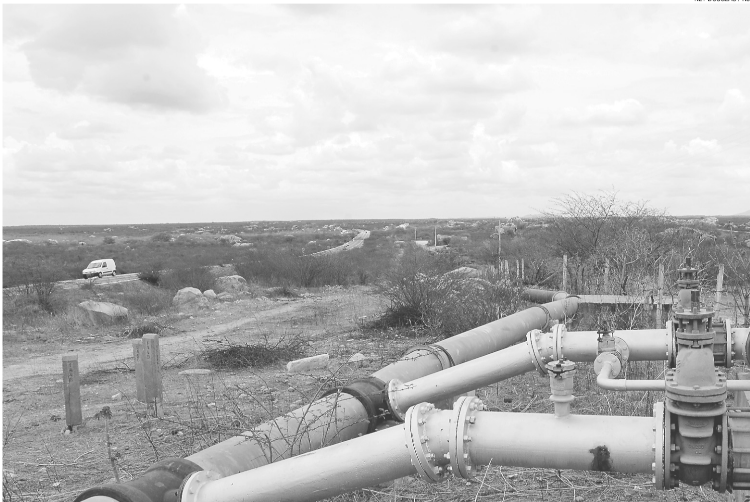
▶ Sistema Adutor Sertão Central, o primeiro de grande porte a ser instalado no Rio Grande do Norte, foi considerado a redenção da região
