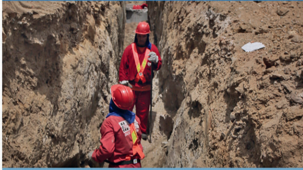
ESGOTAMENTO SANITÁRIO AREIA BRANCA
