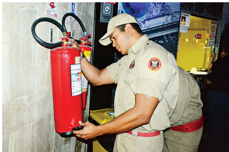
► Bombeiros fiscalizam situação dos extintores
