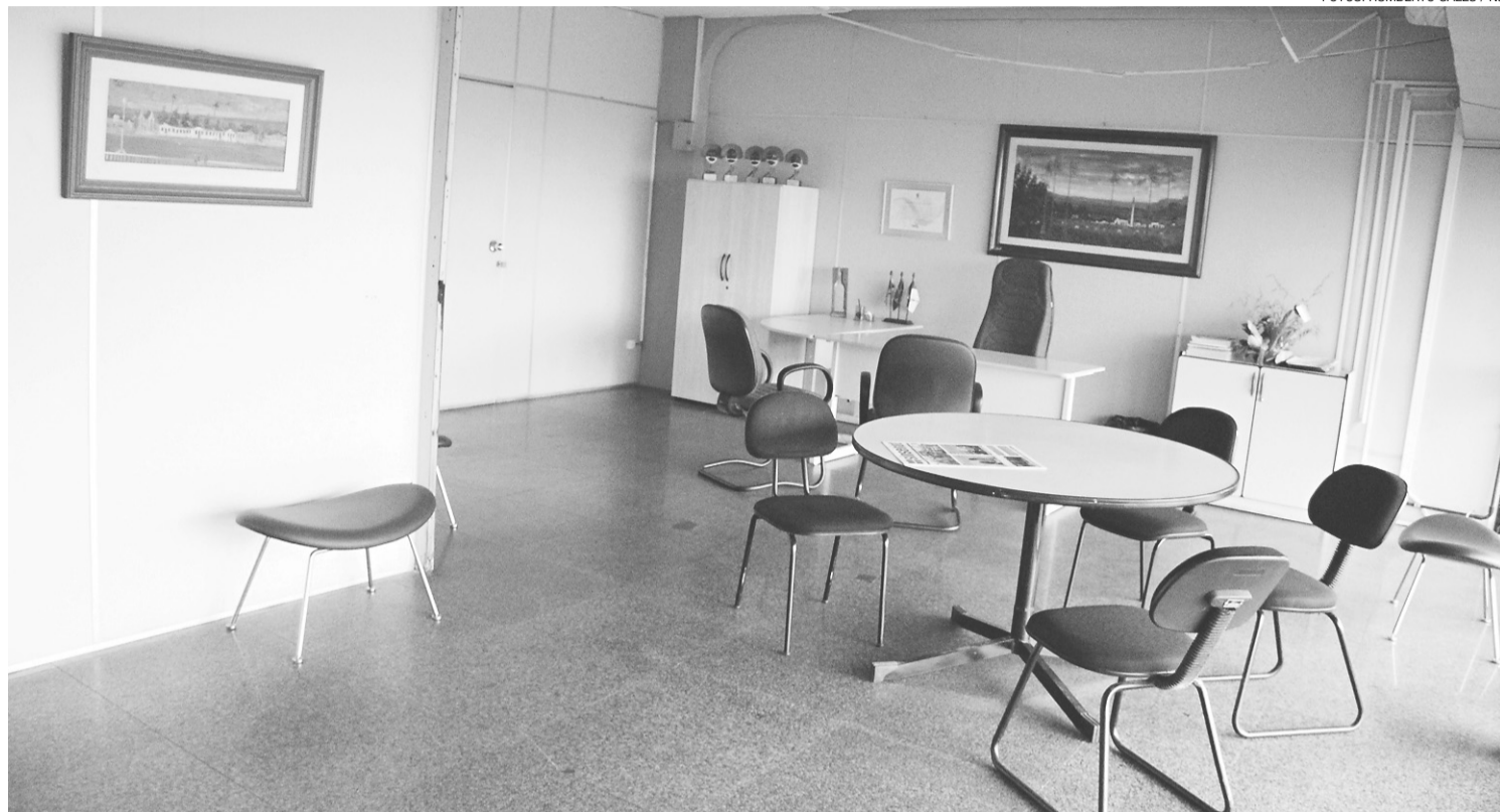
► Sala da presidência: fios espalhados pelo teto, paredes manchadas, janela quebrada, cadeiras sujas, ar condicionado sem funcionar
