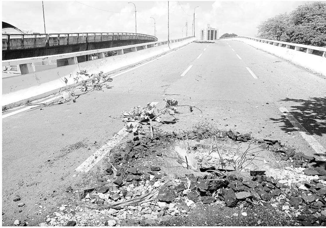
▶ Doze pessoas, entre técnicos e engenheiros, trabalharam na avaliação do grau de comprometimento da estrutura
