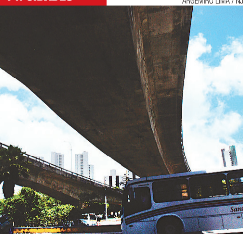
Viaduto do Baldo está interditado há dois meses
