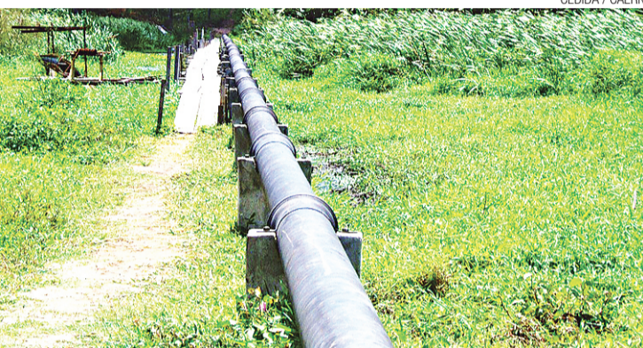
► Adutora de Serra de Santana: no desespero, sujeita a desvios
