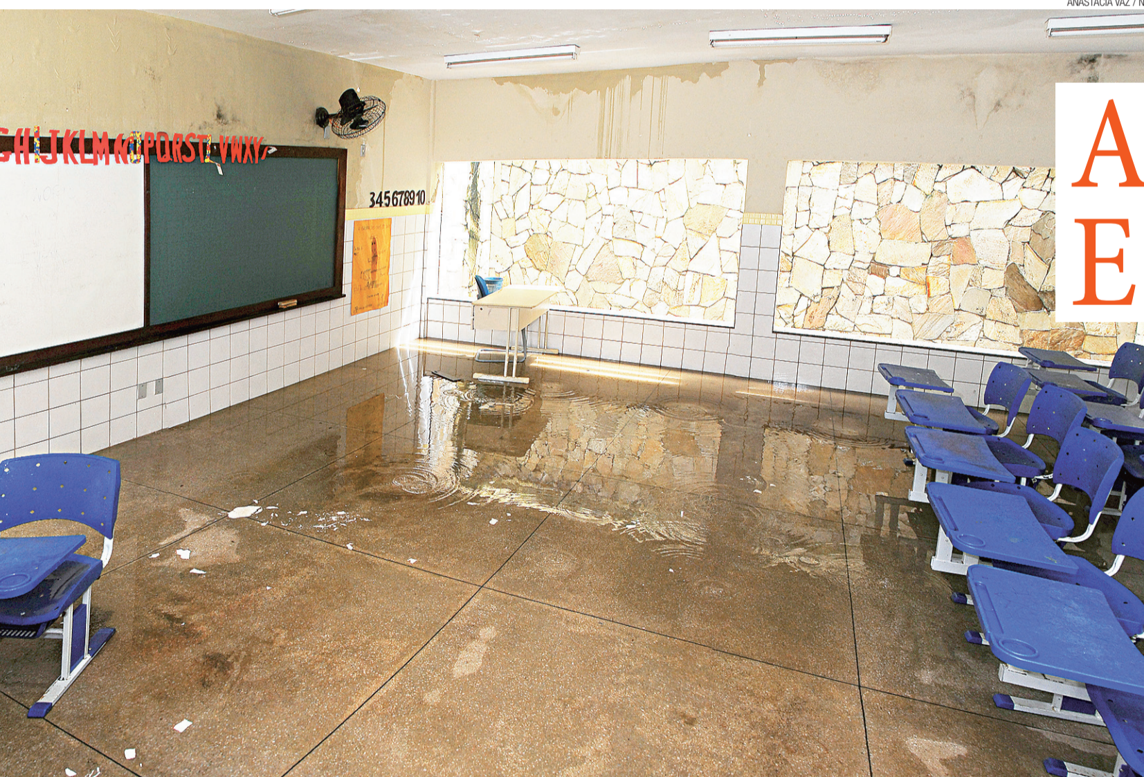
Na Escola Municipal Joaquim Honório, em Dix-Sept Rosado, parte dela interditada há um mês, estudantes enfrentam rodízio: oito das doze salas de aula estão interditadas
