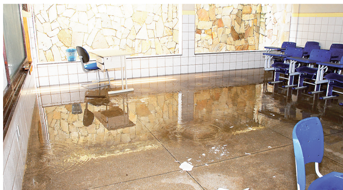
► Na Escola Municipal Joaquim Honório, não se vê nem o chão com o volume de água no chão
