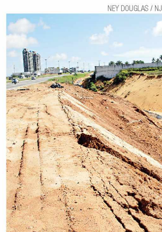
▶ Trecho de BR desabou em janeiro
