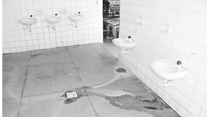
▶ Escola Carlos Bello Moreno, no conjunto Jiqui: vazamento nos banheiros, telhado com goteiras
